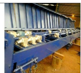
Fig. 2. TMT QUENCHING BOX
