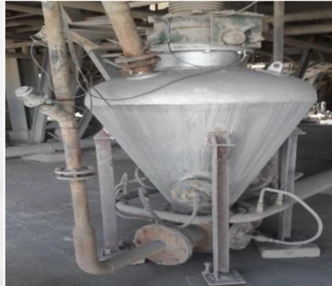
b) ESP blow tank
